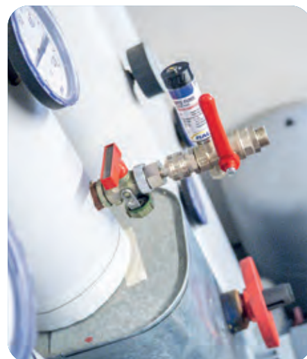
Überprüfung der Heizungsanlage bei höher gelegener Leitung
